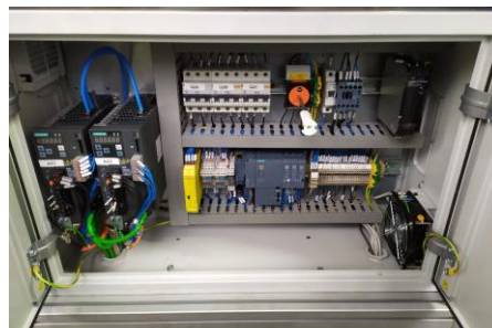
(vista interna quadro elettrico)
