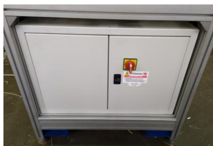
(vista esterna quadro elettrico)
